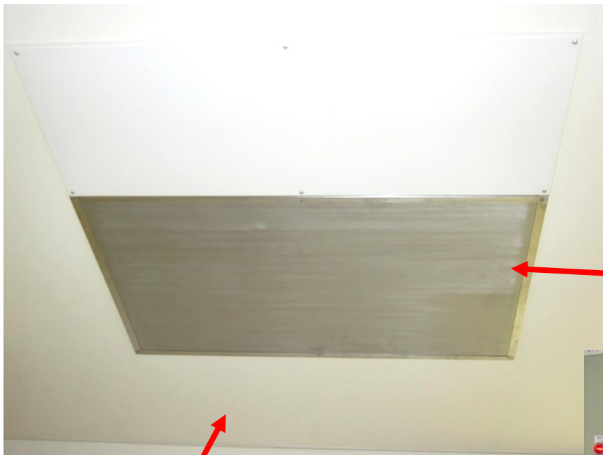
クリーンルームの天井
