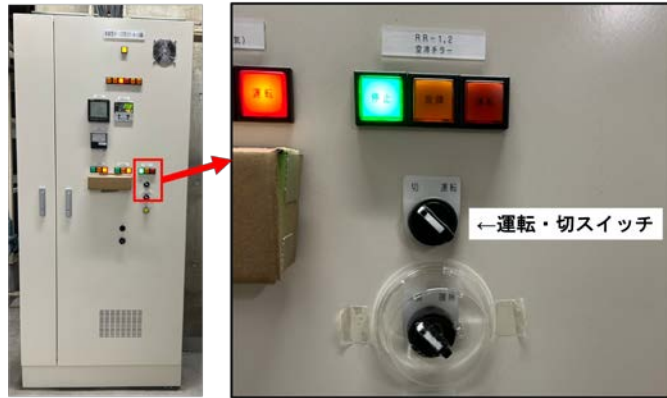
空調用熱源操作監視盤
