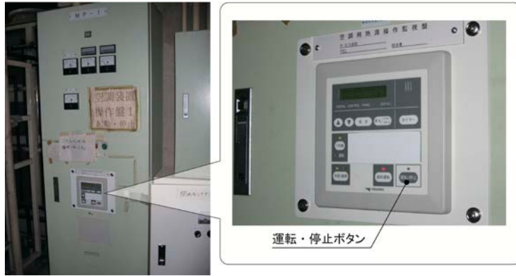
空調用熱源操作監視盤
